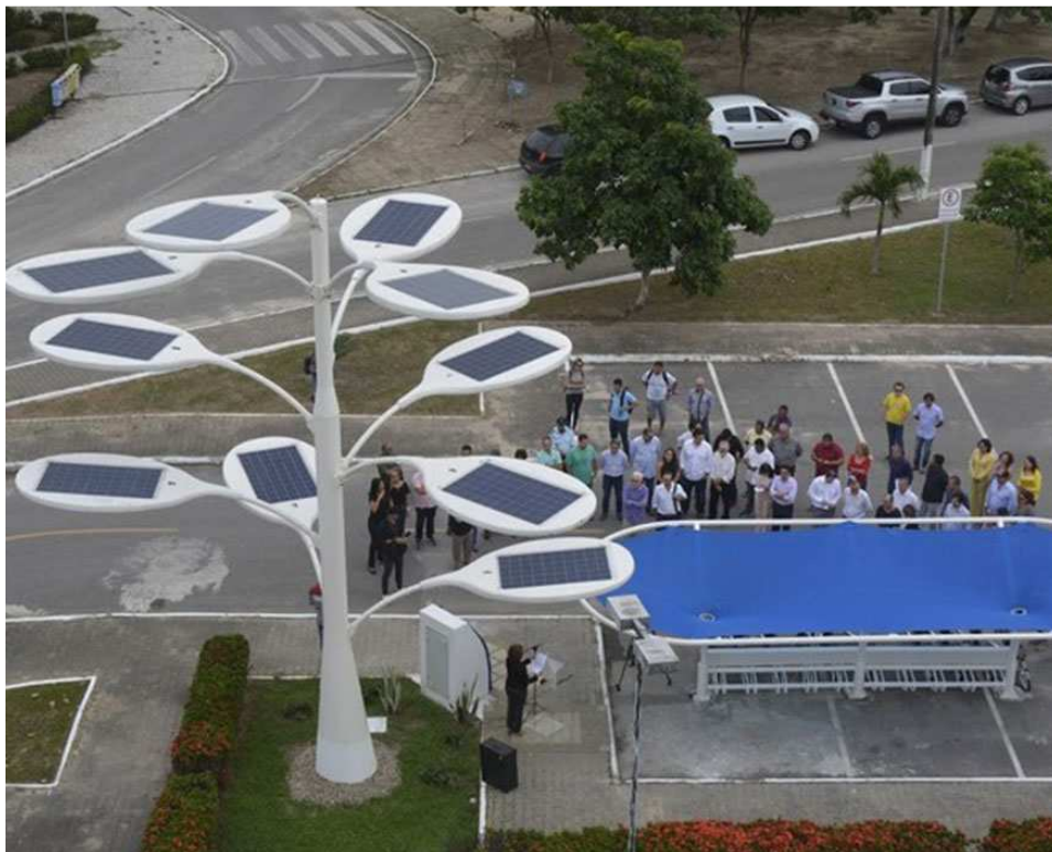
Placas Fotovoltaicas - Árvore Solar - Universidade Estadual do Ceará Carregam bicicletas elétricas
