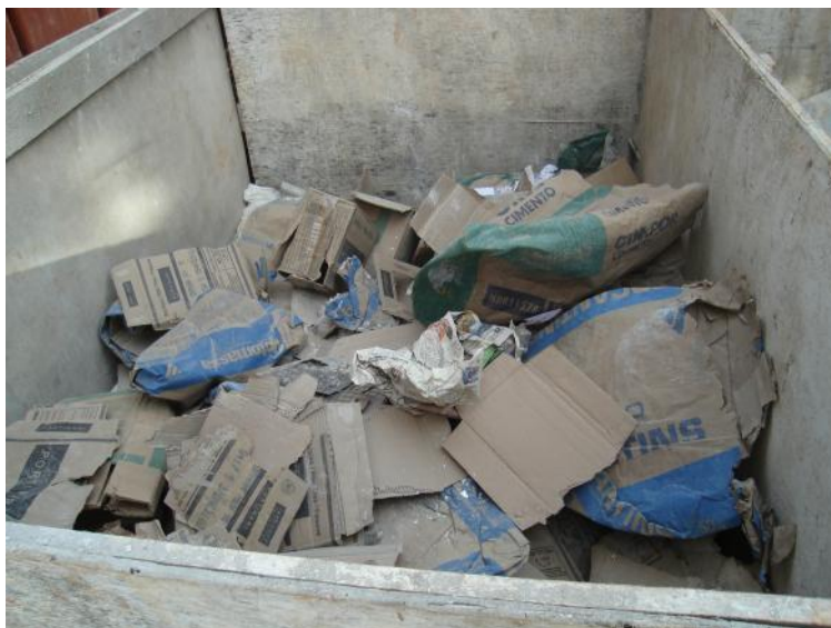
Figura 1: Baía contendo restos de sacos de cimento e papelão (Maio de 2008)
