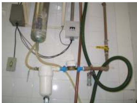
Tubulação de alimentação – destilador
