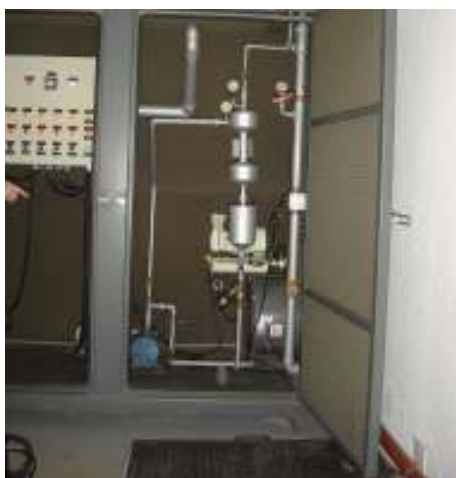
Figura 5.9: Sistema de operação da ETE – automatizada.
