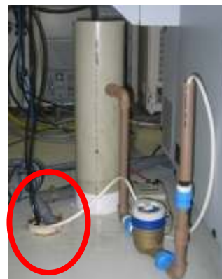
Tubulação de descarte na rede
