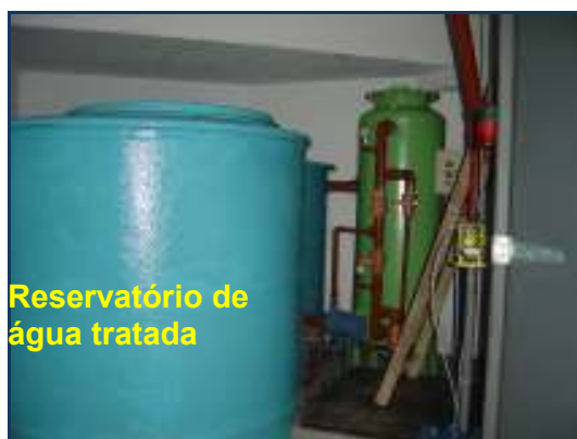
Figura 5.8: Tratamento terciário– filtração e desinfecção.
