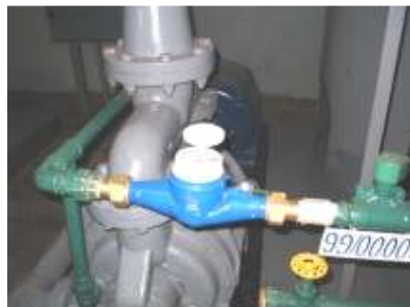
Tubulação de descarte – bomba a vácuo
