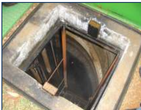
Figura 5.5: Tratamento preliminar – reservatório de retenção com peneira.
