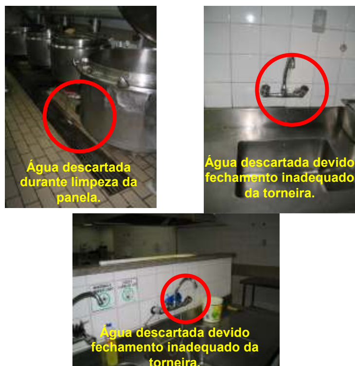
Figura 3.6: Perdas encontradas no levantamento em campo efetuado no HC/UNICAMP.
