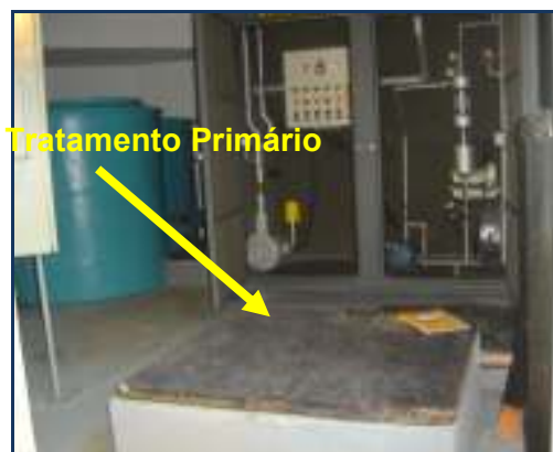
Figura 5.6: Tratamento primário– equalização de vazões e decantação.
