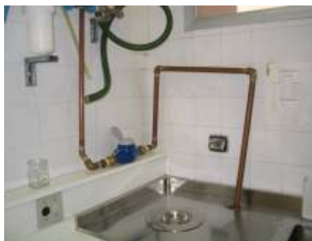
Tubulação de descarte - destilador
