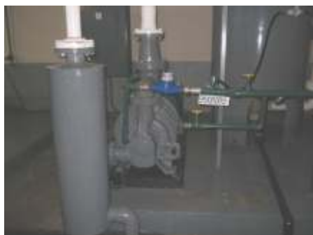
Tubulação de descarte – bomba a vácuo
