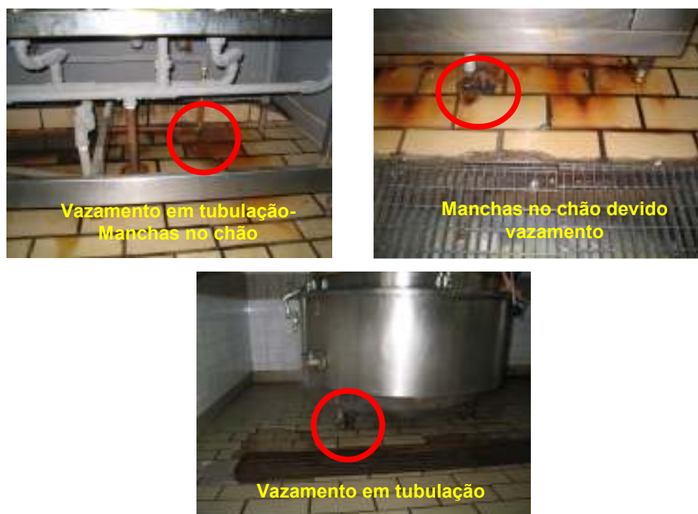
Figura 3.5: Patologias encontradas nos EUEA do 1º Pavimento – DND do HC/UNICAMP.
