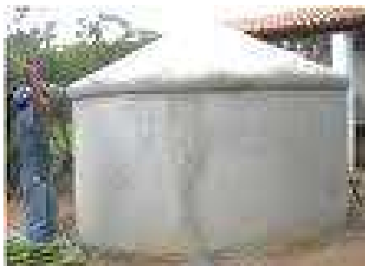
Cisterna de ferrocimento: vantagem de não permitir o aquecimento d'água
