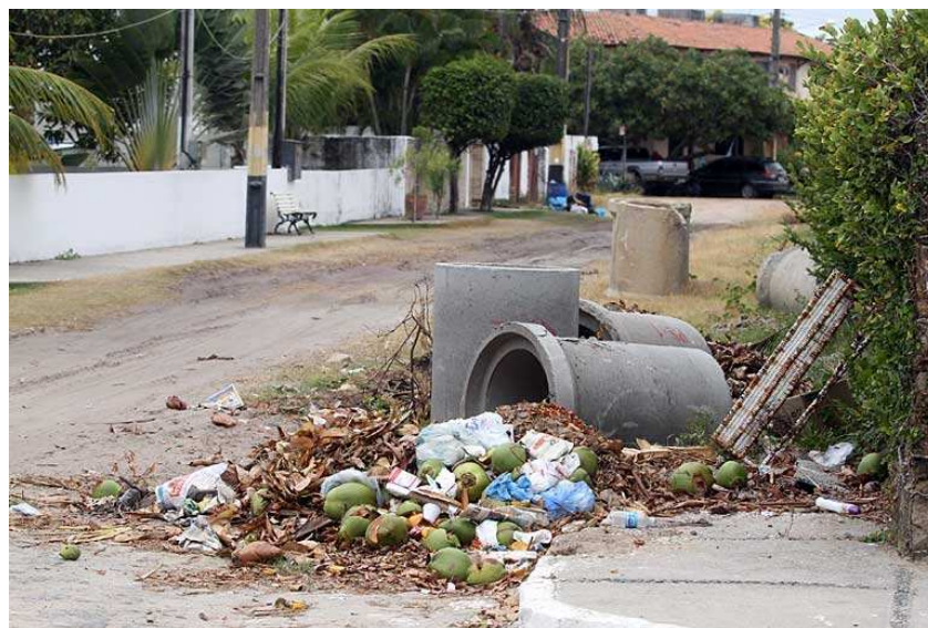
Bueiro entupido: ruas alagadas e cursos d'água poluídos durante as chuvas
